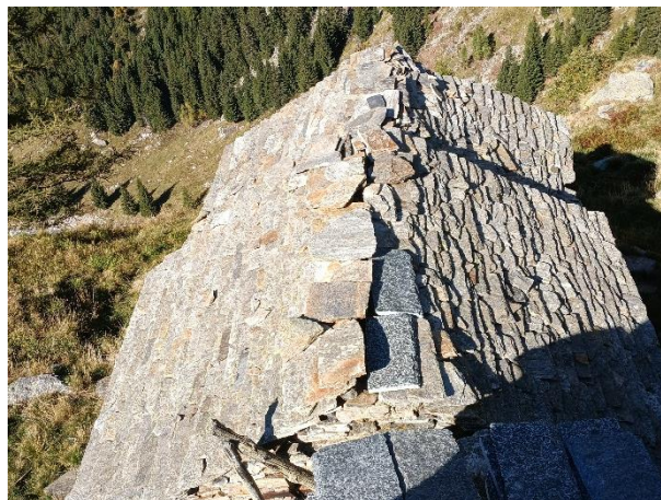
Img. 5: Dettaglio colmo dissestato
