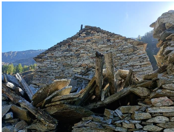
Img. 3: Parte crollata vista da sotto
